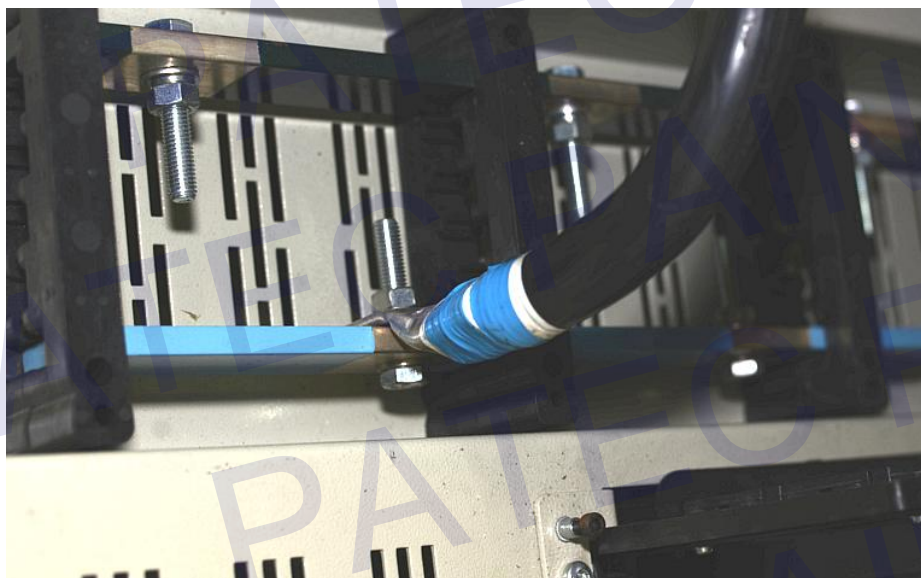
Fotografia 7: Detalhe da alimentação na barra de neutro antes da aplicação de corrente.
