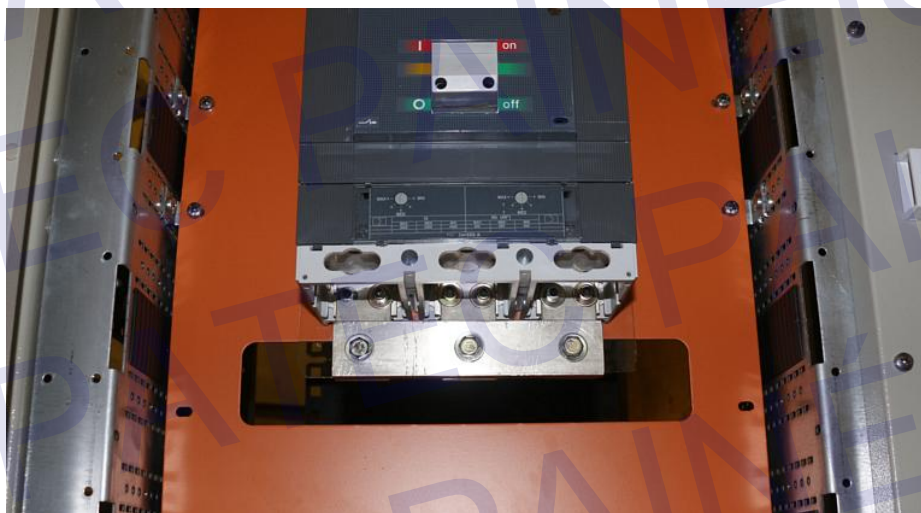
Fotografia 4: Detalhe da ligação de curto-circuito da 1ª aplicação no circuito principal antes do ensaio.
